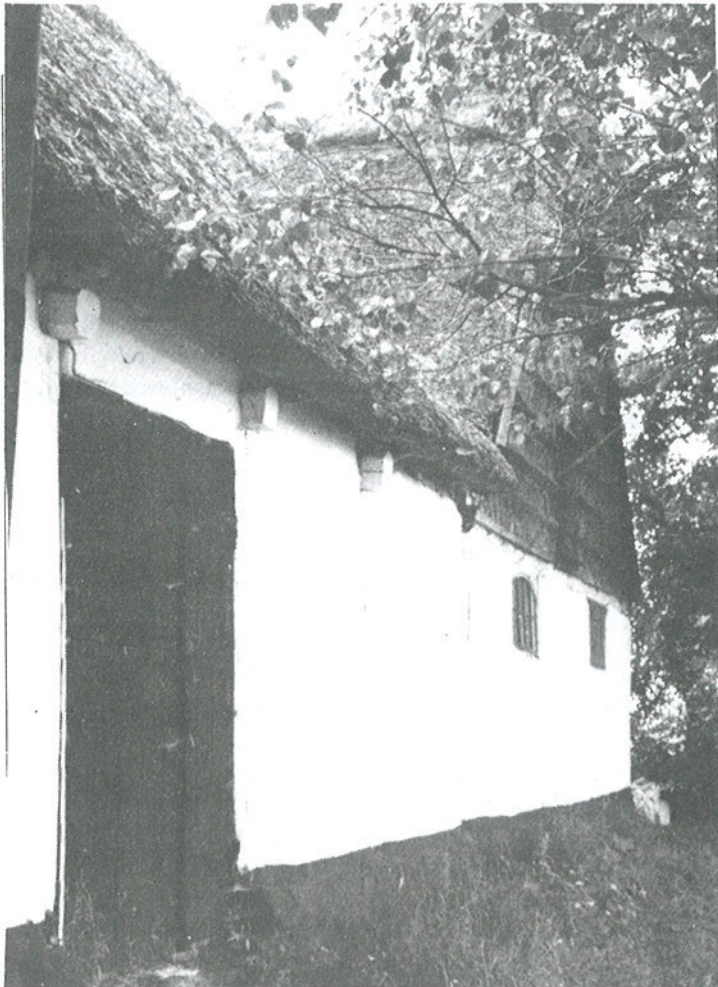
Spøllandsk bygningsværk gennemstrukne bjælker Foto: J. La. Tøndelgårde
